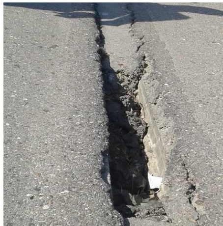
Grieta en superficie de rodadura Tramo San Pedro Sula - Cortés
