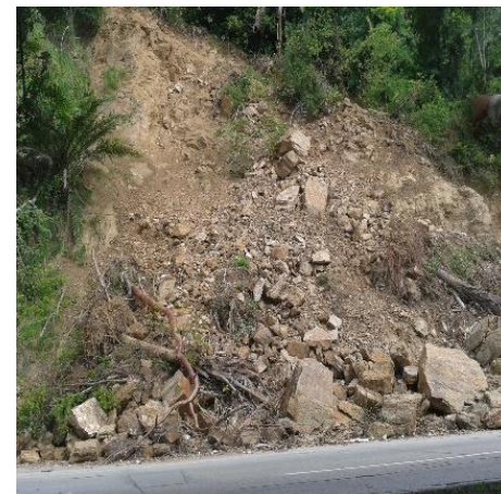
Derrumbe sin remover en Km 24 tramo SPS – Puerto Cortés
