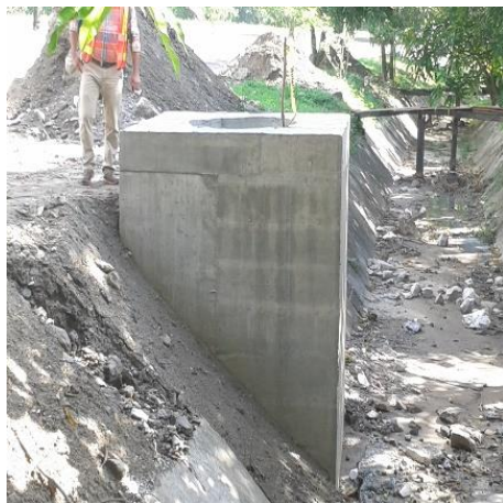
Estructura para postes de energía eléctrica cerca del hombro
