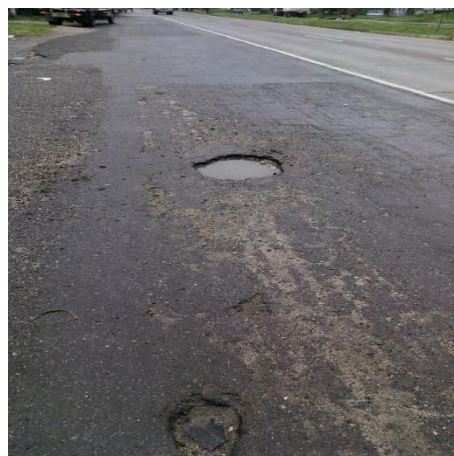
Bache en Hombro en estación 14+500, Tramo SPS- Cortés
